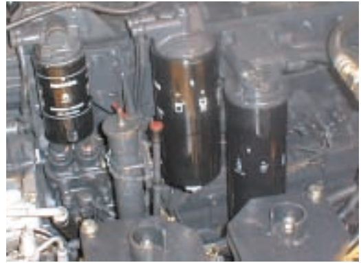
写真12 エレメント類の集中配置
