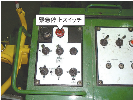
写真5 緊急停止スイッチ
