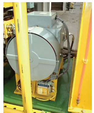
写真3 ヒーティング用発電機
