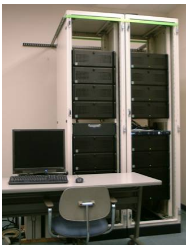
図1 並列計算機 KHPC の外観
