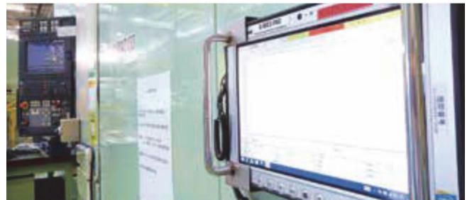
図3 測定用タブレット端末設置状況
