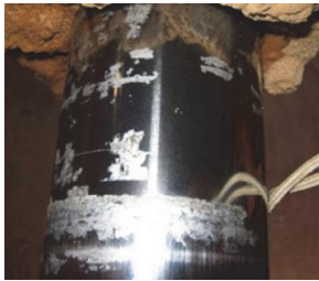
図2 シリンダロッドの発錆
