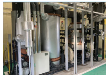
茨城工場のバイオマスボイラー
